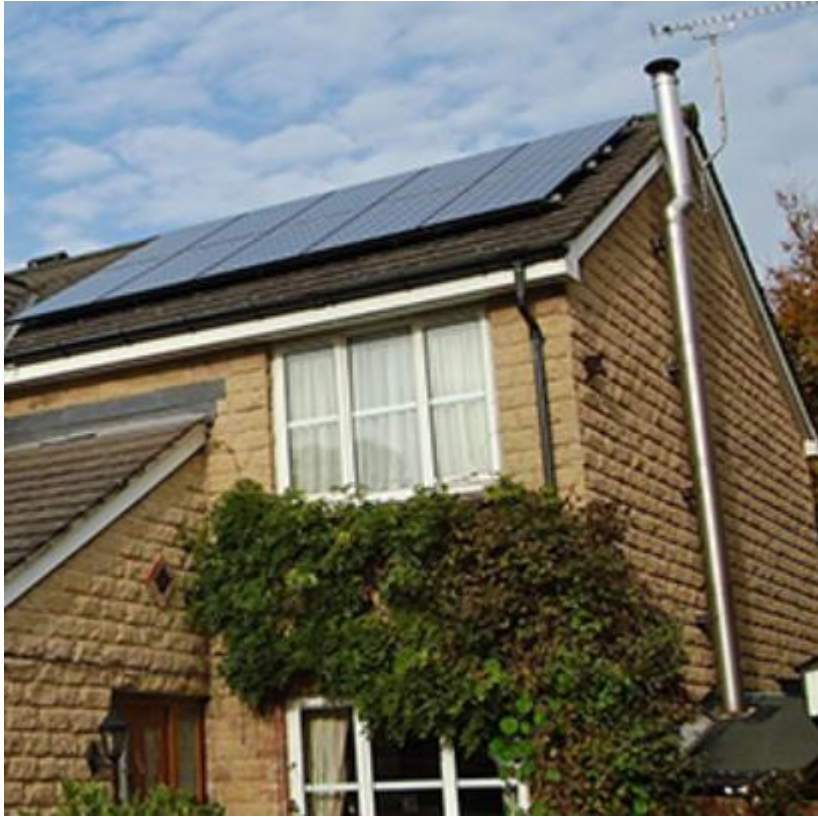
4kW solar PV
